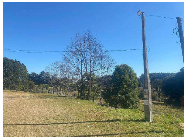
Figura 3: Rede elétrica para ligação.
